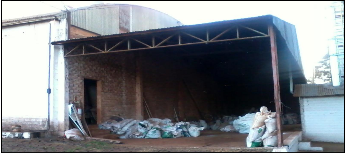
Figura 9: Local destinado a instalação do secador de grãos.
