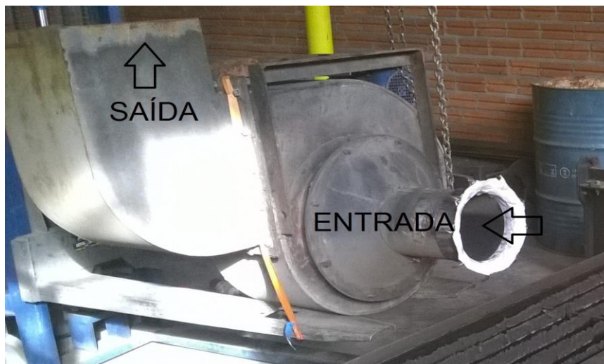
Figura 5 – Posicionamento do exaustor na mesa de corte.
