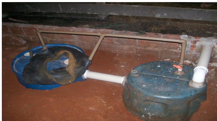
Figura 16 – Gasômetro e câmaras instaladas
