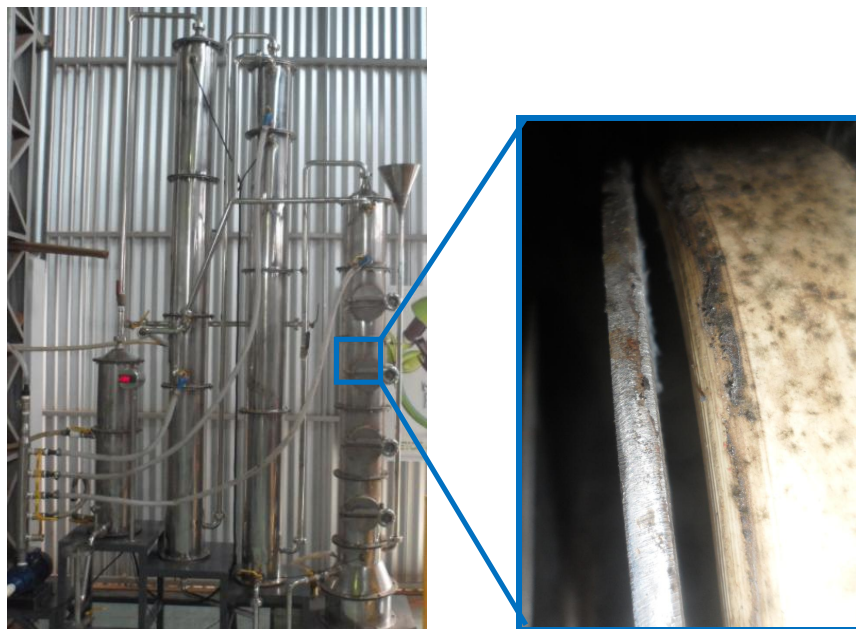
Figura 6 – Folga existente na janela de inspeção
