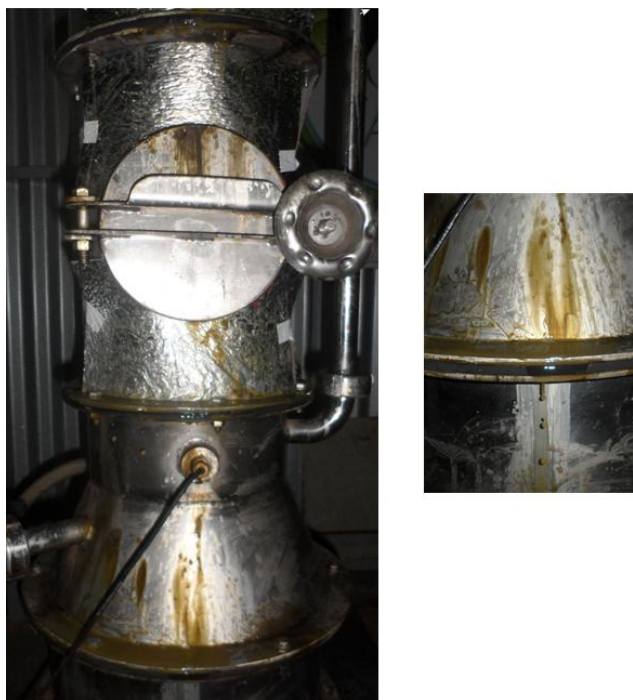
Figura 10 – Vazamentos nas janelas de inspeção
