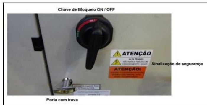
Figura 12 – Proposta de chave de bloqueio do quadro de energia da célula robotizada.
