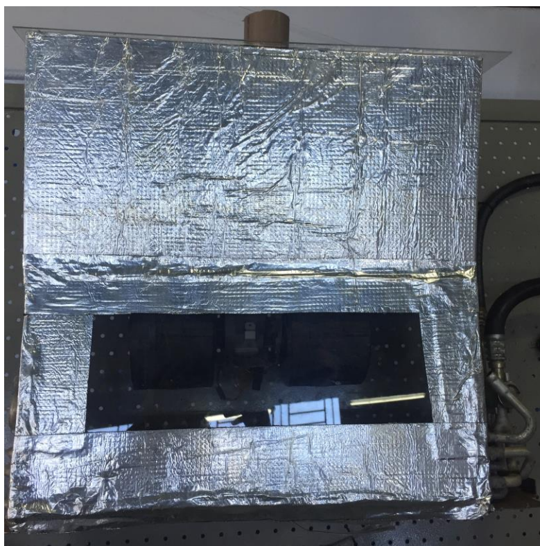
Figura 16- Nova caixa de reservatório do ar refrigerado.
