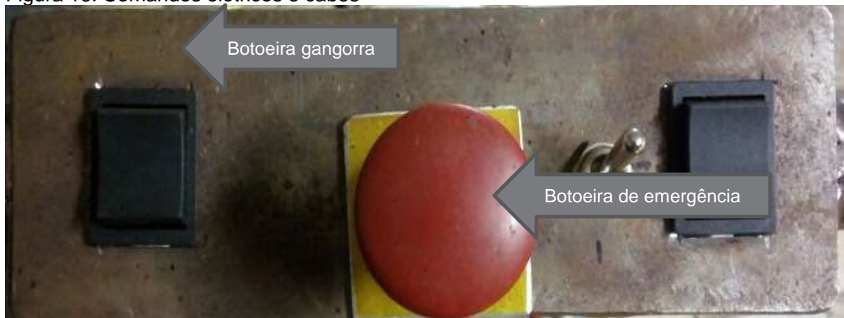
Figura 16: Comandos elétricos e cabos
