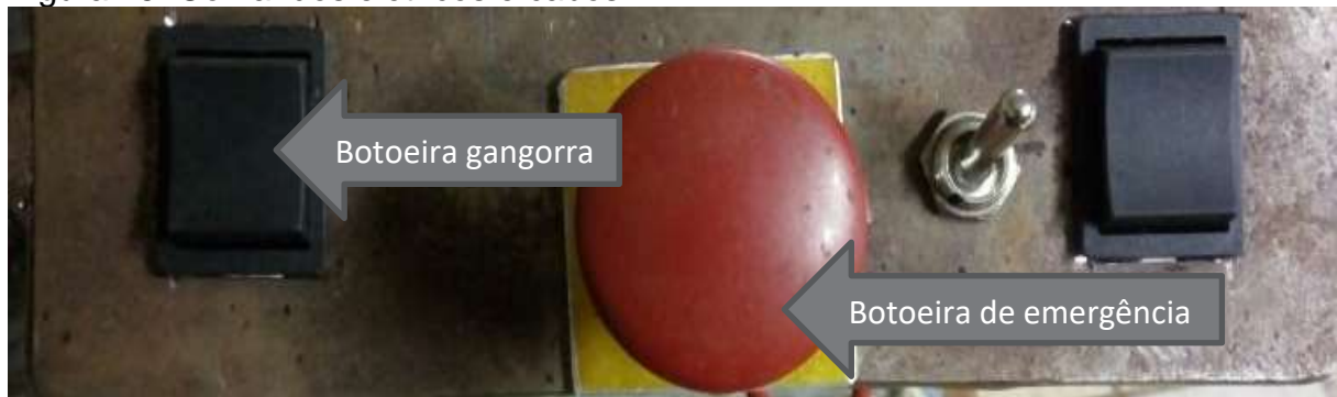
Figura 15: Comandos elétricos e cabos
