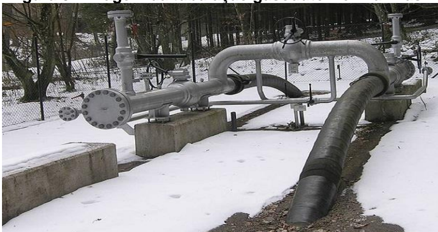
Figura 3 - Imagem da tubulação gasoduto Bolívia Brasil.
