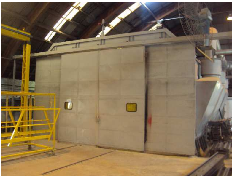
Figura 27: Nova cabine de pintura
