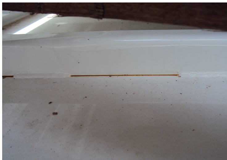
Figura 5: Óxido laranja sobre a pintura
