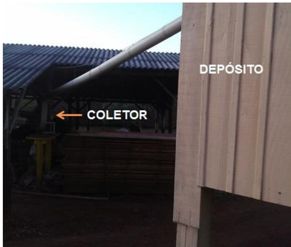
Figura 6 – Canalização do exaustor até o depósito para estocagem adequada.
