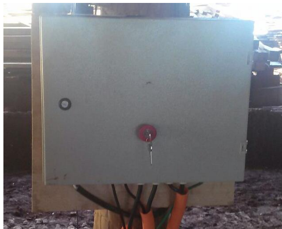
Figura 8 – Quadro de luz com chave usado como sistema de segurança para energização da plaina desengrossadeira.
