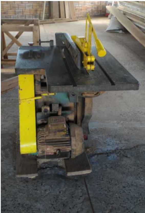
Figura 09 - Proteção nas partes móveis de metal da serra circular.
