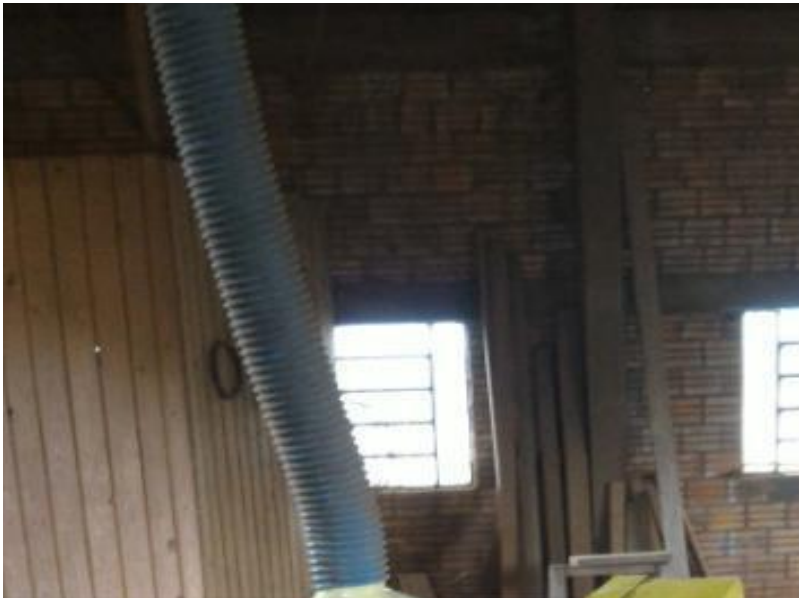
Figura 14 – Canalização do sistema de ventilação e exaustor.
