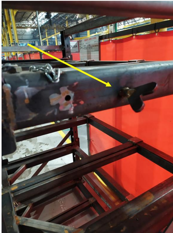
Figura 40 – Deslocamento da trava da abertura
